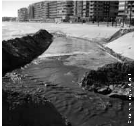
Dragado y vertido de lodos contaminados directamente al mar.
