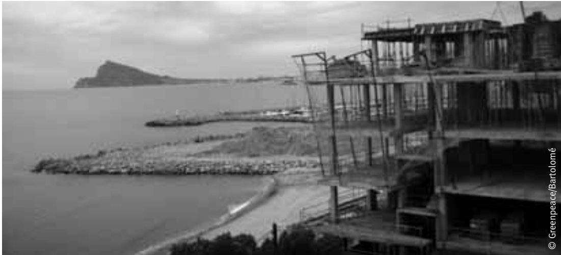
Construcción de edificios junto al puerto deportivo Luis Campomanes en Altea, Alicante.
