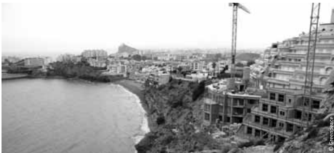
Construcción desmedida en la bahía del Hornillo, Águilas.
