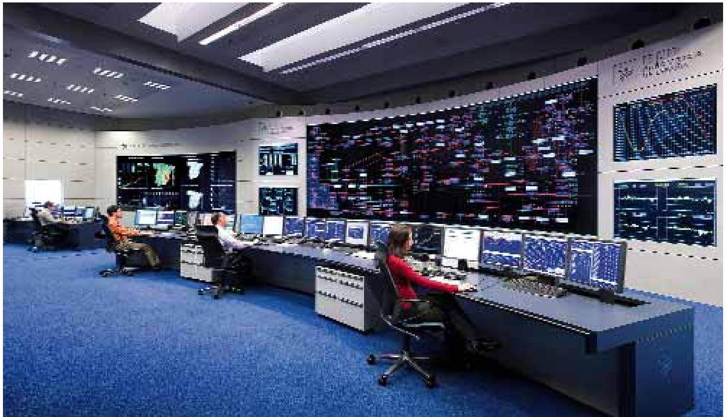
figura 18: el Centro de Control de Energías Renovables (CECRE)
